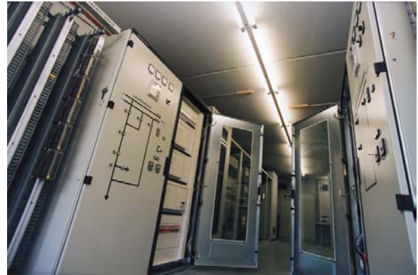
400 kV line feeder kiosk
