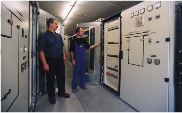
400kV bus coupler kiosk
